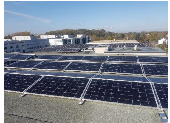
Photovoltaik-Anlage auf unseren Gebäuden
